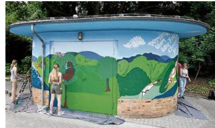
Das Pumpwerk an dem stark frequentierten Fußweg wurde immer wieder beschmiert. Um dem vorzubeugen, setzt die Gemeinde auf das Graffiti-Projekt.
